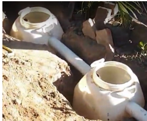
Figura 2- Filtros da estação de tratamento conectados por tubos de PVC
